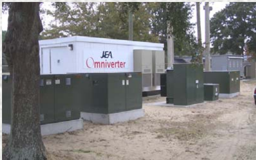
安装在户外的整套2MVA、26.4KV AVC系统。
