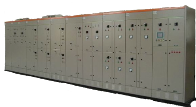
漕泾化工厂 20万吨苯酚丙酮 MUPS
