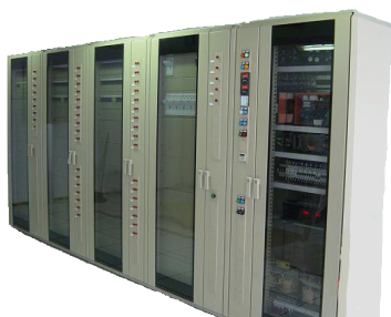
洛阳石化厂 短丝一线DC-BANK
