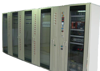
洛阳石化厂 短丝一线 DC-BANK
