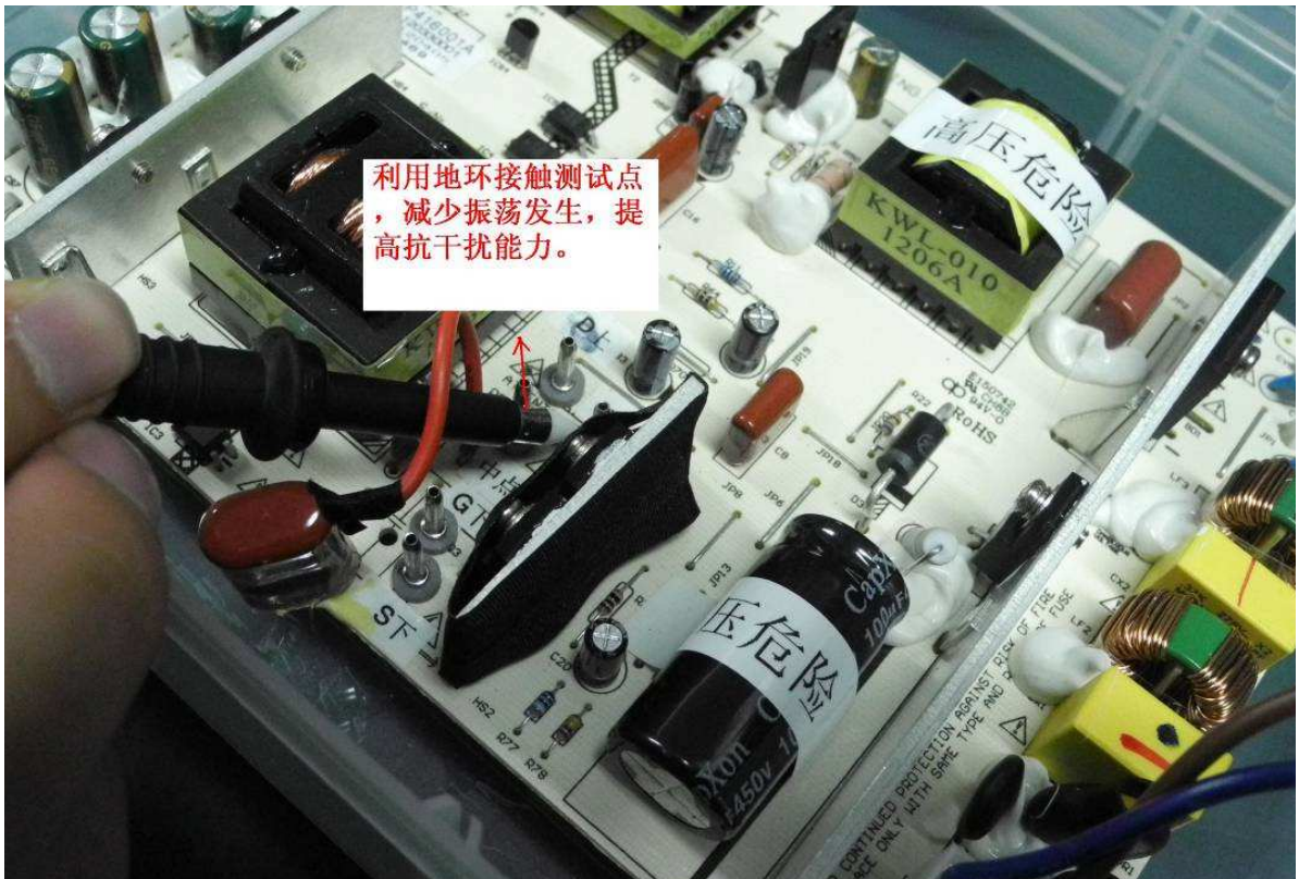
图22 示波器地线去掉，利用地环取代长地线，振荡减小，干扰最小，测量误差最小
